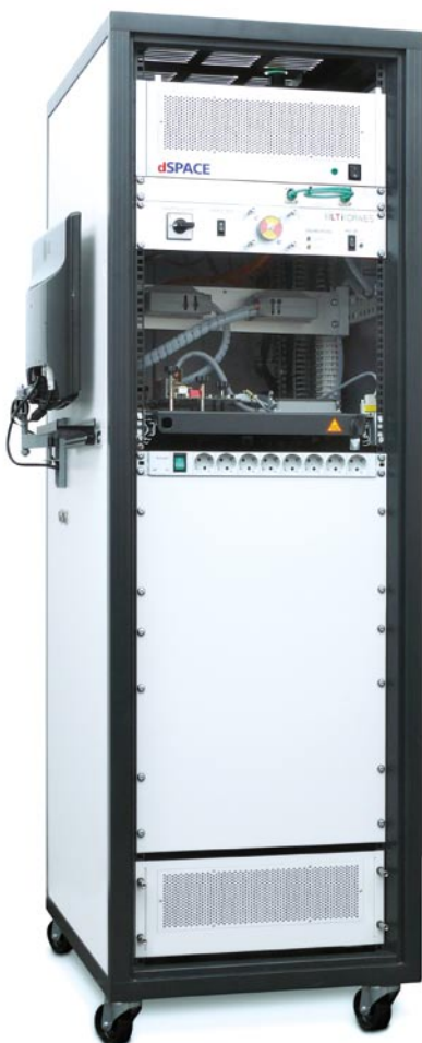
Abbildung 2: Der Schaltschrankaufbau des HIL-Simulators.
