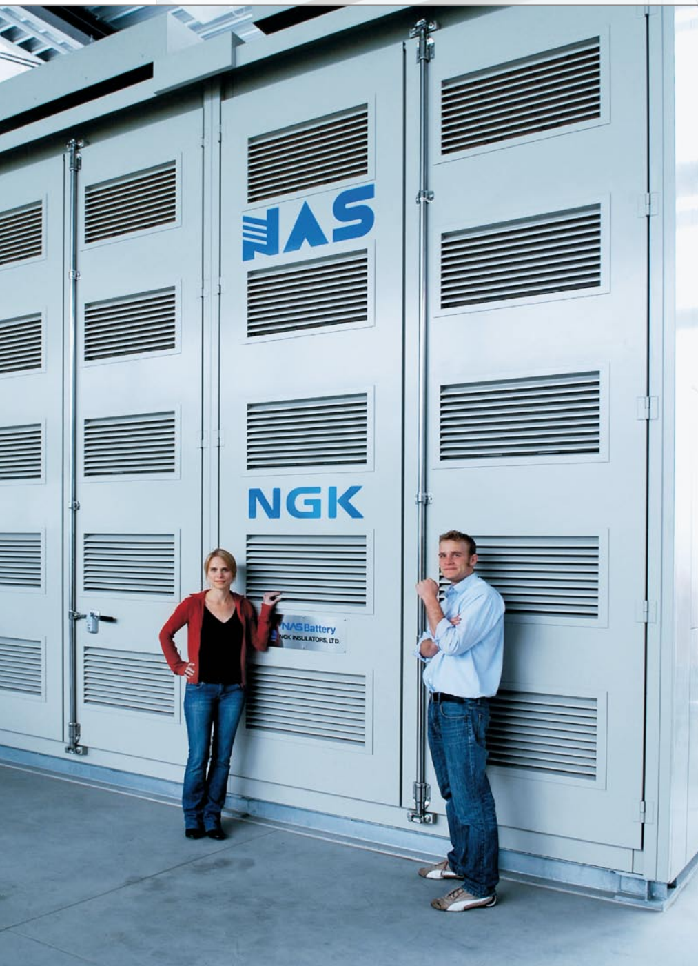
Abbildung 3: Die Natrium-Schwefel-Batterie gleicht Energieschwankungen aus und dient als Reserve für schlechte Zeiten.
