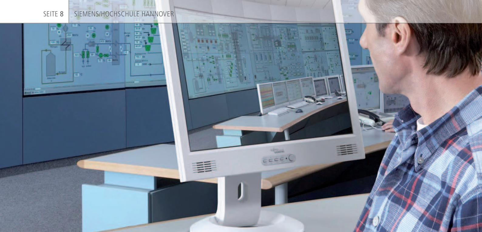
Abbildung 3: Mit dem Leittechniksystem T3000® der Siemens AG werden große Dampfturbinenkraftwerke automatisiert.
